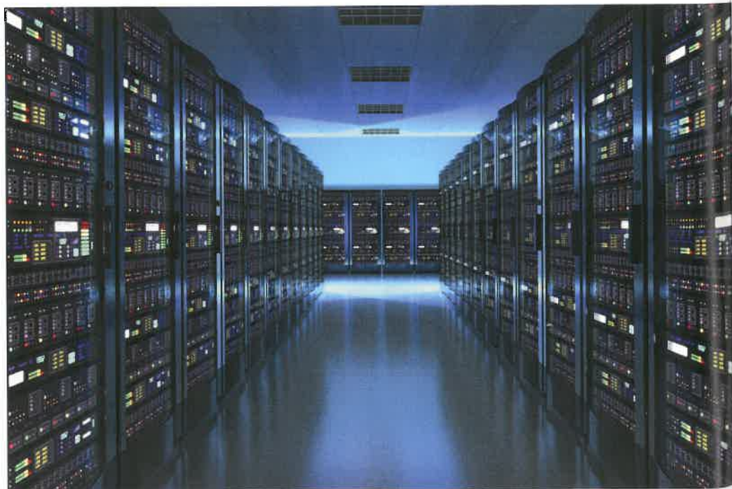
Die Anforderungen an die Funktionalität von Rechenzentren sind immens. Brandmelde- und Löschanlagen, Zutrittskontrollsysteme und eine unterbrechungsfreie Stromversorgung sind nur einige davon.
